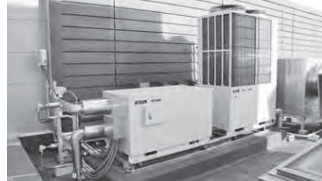
公共施設に導入された「ヒートポンプ」
